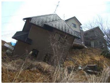
仙台市盛土造成地の被害
