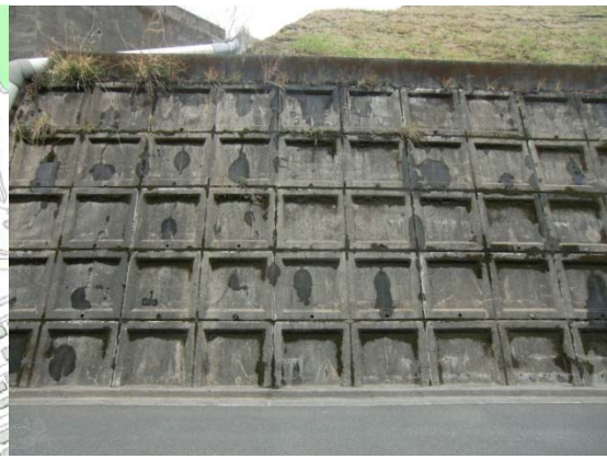
亀裂が入っており晴れの日でも水が浸み出し
